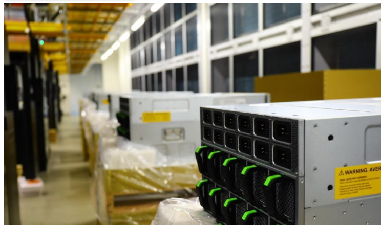
国内第 1 号 AI データセンターに搬入された GPU サーバー
